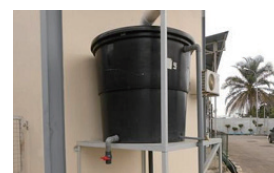
雨水の貯水タンク (ブラザーインダストリーズ テクノロジー(マレーシア)Sdn. Bhd.)
