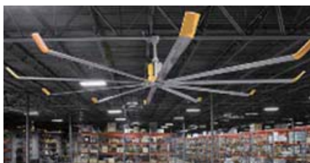
倉庫エリア天井の設備 シーリングファン(左)、特大扇風機(右)
