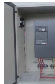
インバーター制御盤
