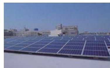
瑞穂工場へ増設した太陽光発電システム
