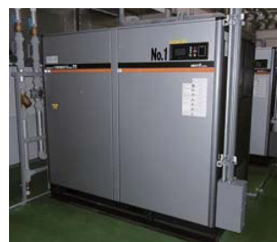
導入したインバーター式コンプレッサー
