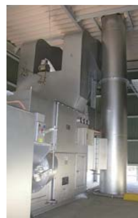
触媒燃焼施設
