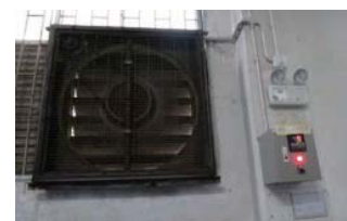
35℃以上で排気扇を稼働させる温度センサー
