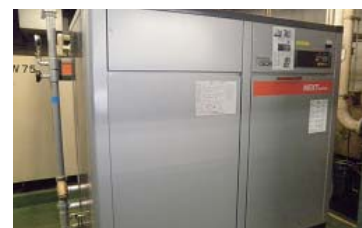
導入したエアコンプレッサー
