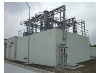
排水処理施設(兄弟機械(西安)有限公司)
