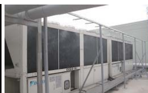
室外機への水噴霧
