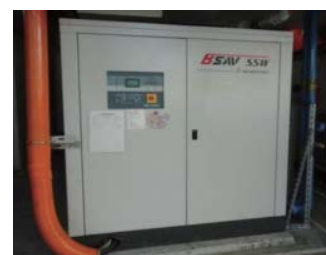
更新したエアコンプレッサー (インバーター方式)
