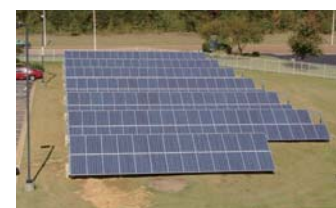
2カ所に設置された太陽光発電システム
