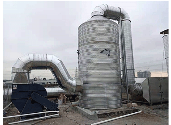
兄弟高科技(深圳)有限公司：VOC 排気処理設備
